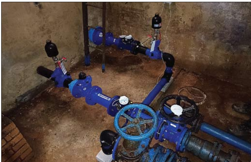
Nové „vystrojení“ starého vodojemu z roku 1978
